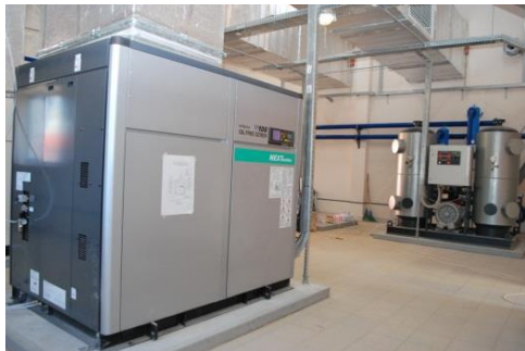
Безмасляная компрессорная станция на заводе фармакологических препаратов «Форт» в Рязанской области.
