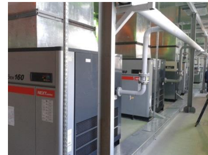
Центральная компрессорная станция ОАО «СТАР» г. Пермь
