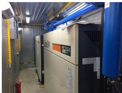
Оснащение блочной компрессорной станции для совместного проекта компаний «Газпром нефть» и «СИБУР»
